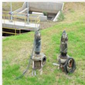
Bombeo de respaldo Estación Gibraltar – Capacidad 2x0.5 m 3 /sg
