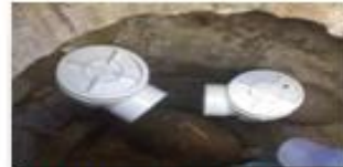
Válvula antirreflujo tipo B – Instaladas en la Localidad de Fontibón
