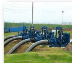
Bombeo de respaldo Estación Gibraltar – Capacidad 4x0.5 m 3 /sg
