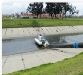
Bombeo de respaldo Canal Cundinamarca – Capacidad 1.2 m 3 /sg
