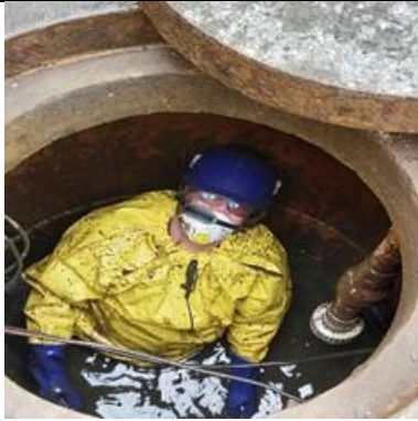
Revisión de bombas
