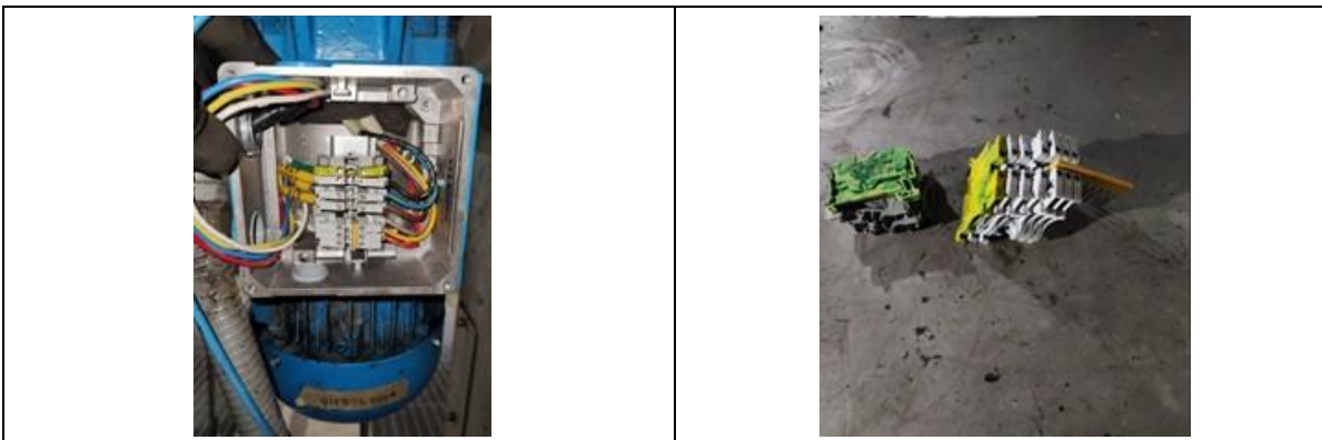
Fotografía 13. Mantenimiento motor reja gruesa 051DGL001A
