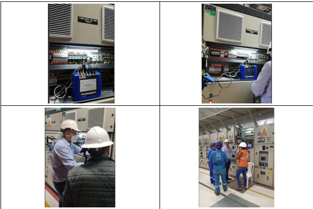
Fotografía 18. Apoyo instalación analizadores de energía
