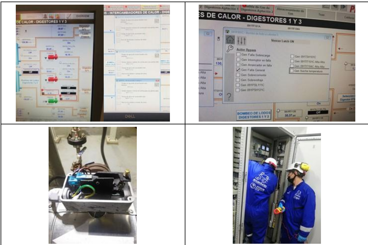
Fotografía 24. Mantenimiento preventivo a los instrumentos 091FSL101A, 091FSL101B y 091FSL101C
