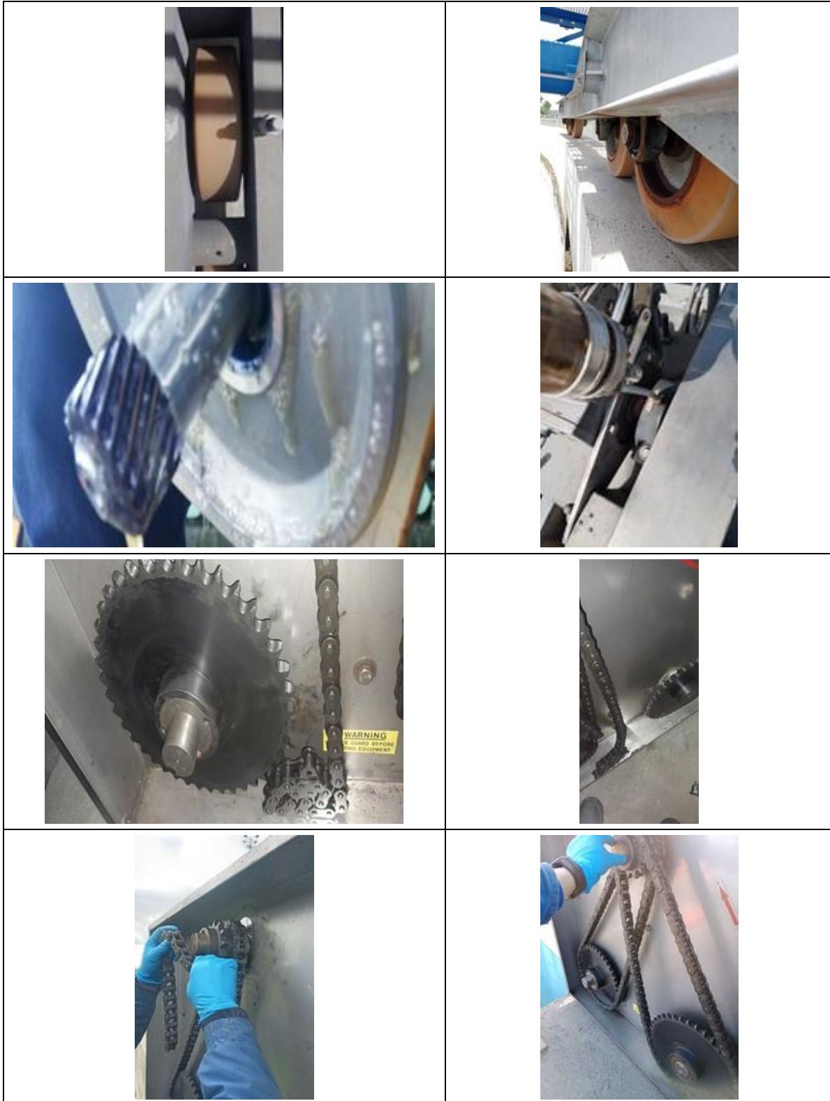
Fotografía 10. Mantenimiento puentes decantadores primarios
