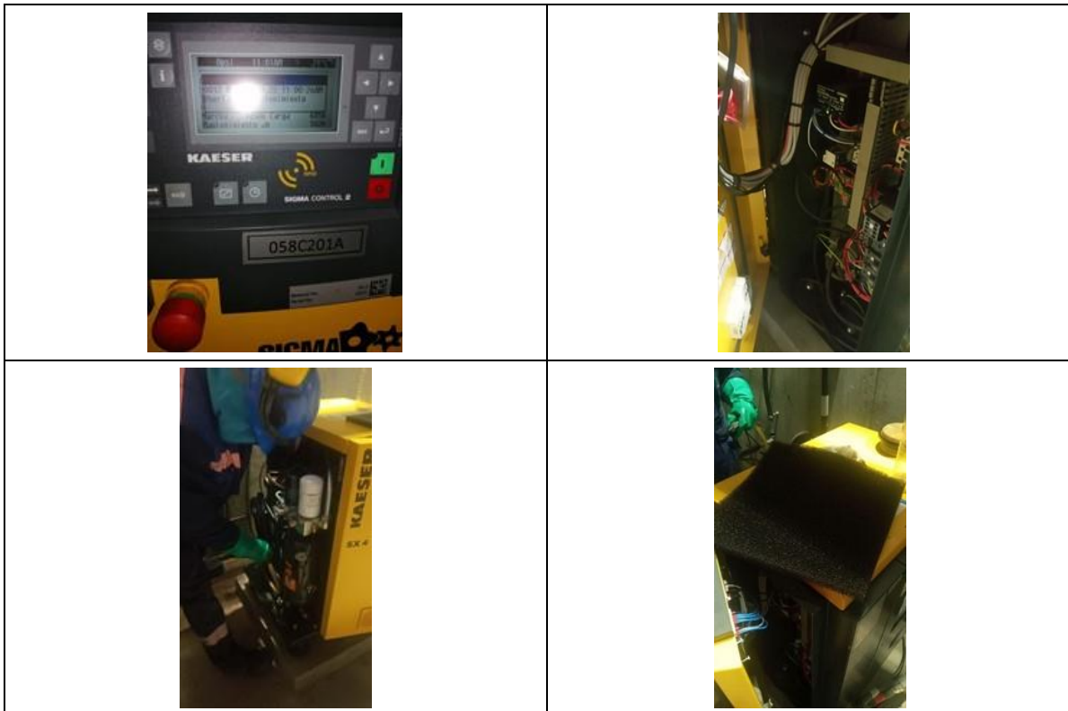
Fotografía 12. Mantenimiento compresores KAESER
