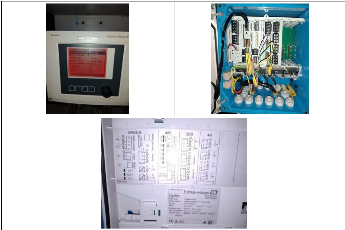
Fotografía 7. Mantenimiento transmisor analizadores reactor 060AIT002E oxígeno disuelto
