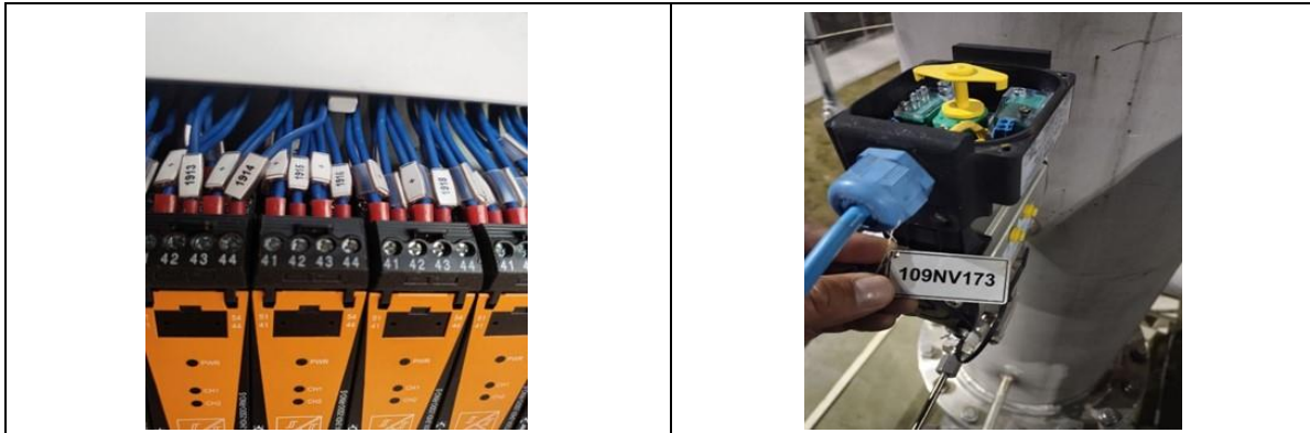
Fotografía 1. Mantenimiento válvula 109NV173
