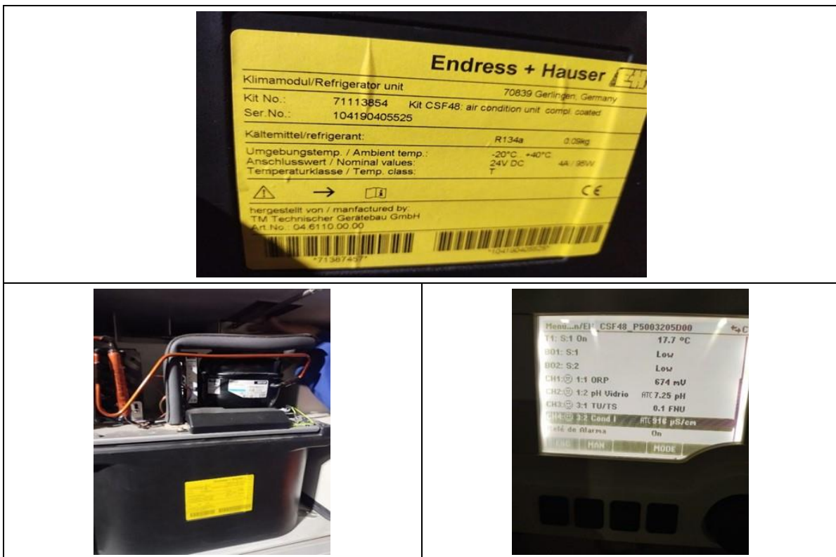
Fotografía 6. Mantenimiento sistema de refrigeración de toma muestra 051TMA001
