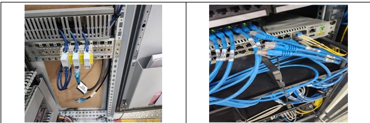
Fotografía 11. mantenimiento tablero de control de la Centrifuga 073SC002A
