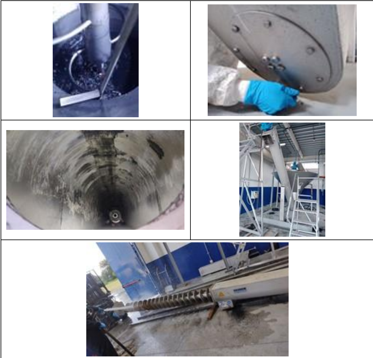
Fotografía 21. mantenimiento clasificador de arenas
