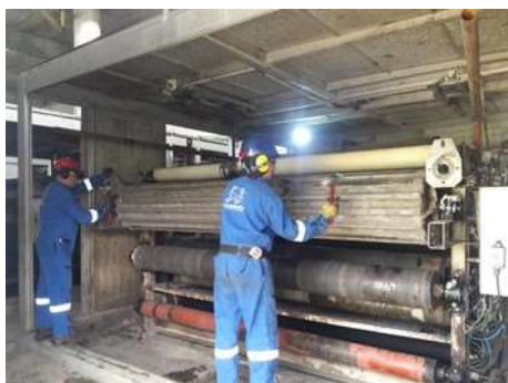
Mantenimiento rodillo Acanalado
