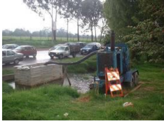
Figura 55. Bomba en el separador central de la Autopista Norte (Fuente: EAAB-ESP)
