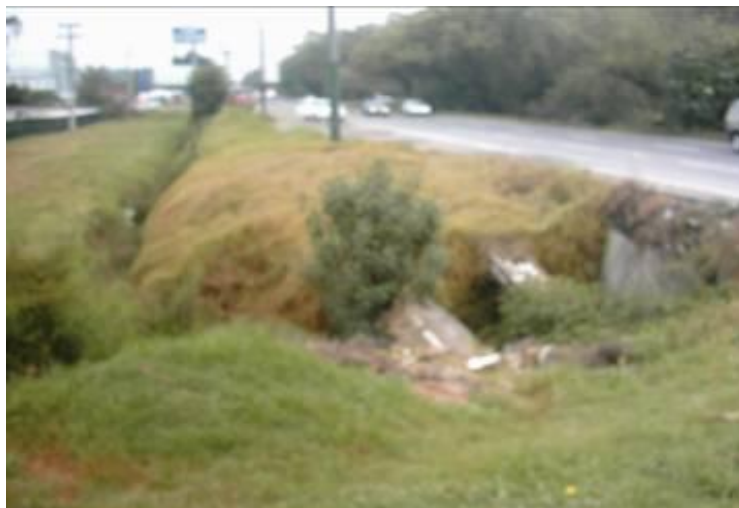
Figura 81. Cruce de la quebrada Torca al costado occidental de la Autopista Norte (Fuente Fotografía: EAAB – ESP)
