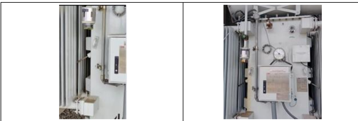
Fotografía 15. Mantenimiento transformador TR03B
