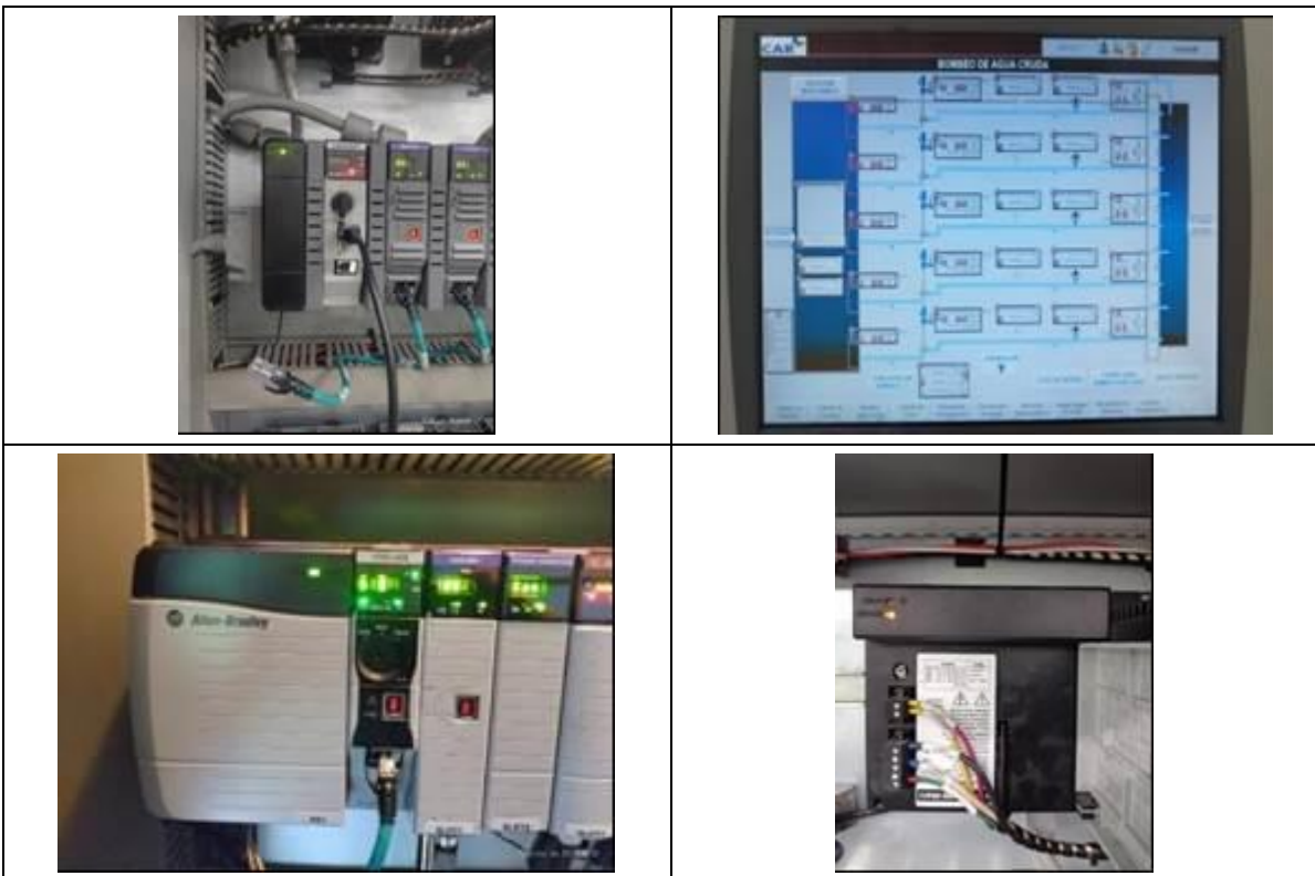
Fotografía 31. Revisión CPU del PLC 01 ubicado en tablero de control 051TCP001
