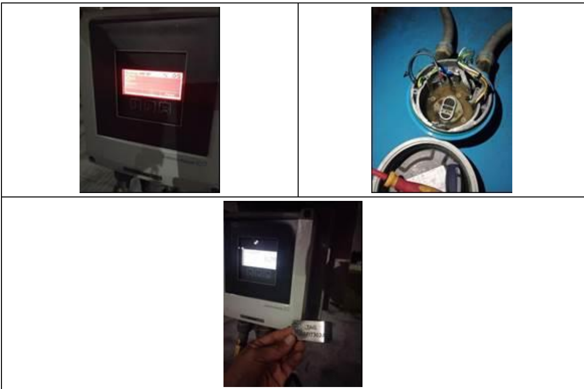
Fotografía 28. Revisión flujómetro electromagnético RAS/WAS 065FIT302A
