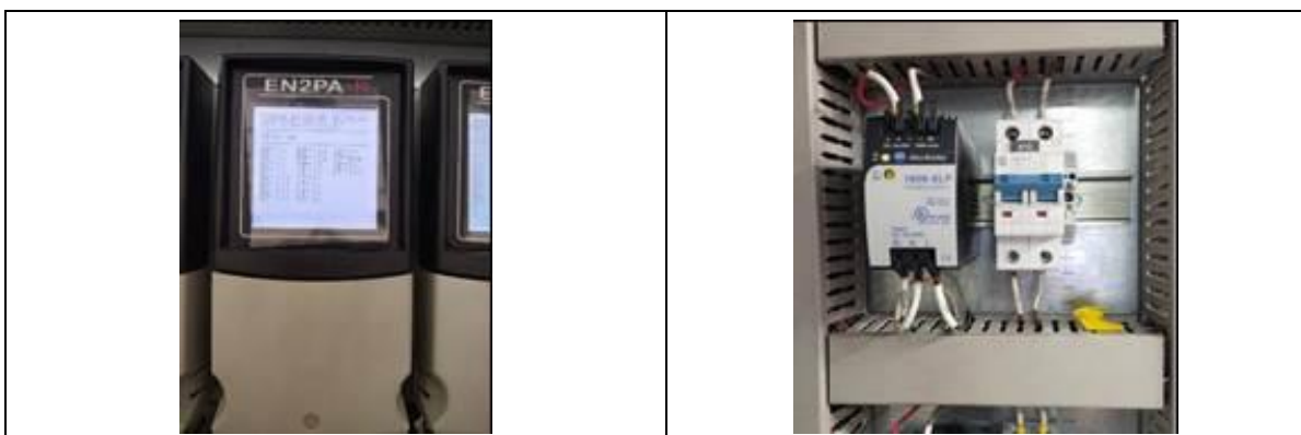
Fotografía 30. mantenimiento transmisores de presión de lavado de telas
