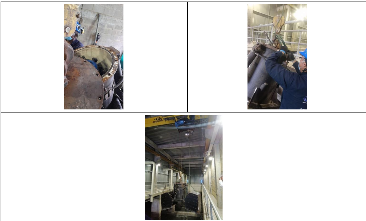
Fotografía 9. Mantenimiento cuchara bivalva PTAR fase II
