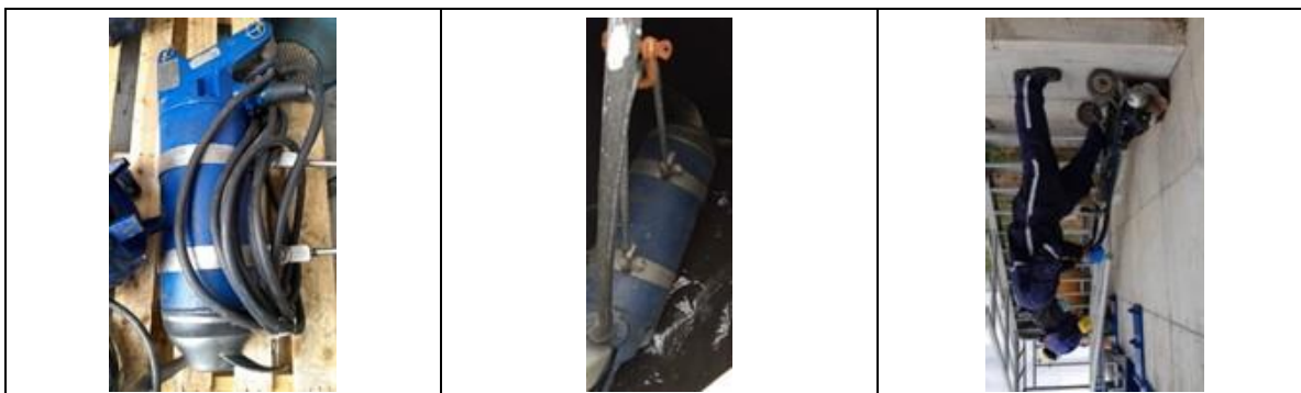
Fotografía 5. Mantenimiento motor del agitador sumergible 060A001L
