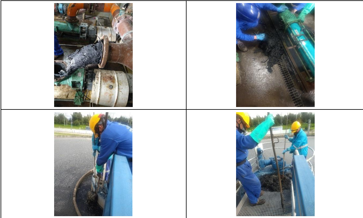
Fotografía 9. tuberías y bombas del edificio (8) espesamiento
