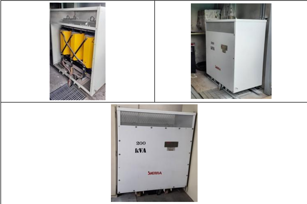
Fotografía 12. Mantenimiento transformadores secos
