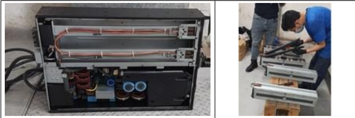
Fotografía 15. Mantenimiento UPS ed. Administrativo y pretratamiento
