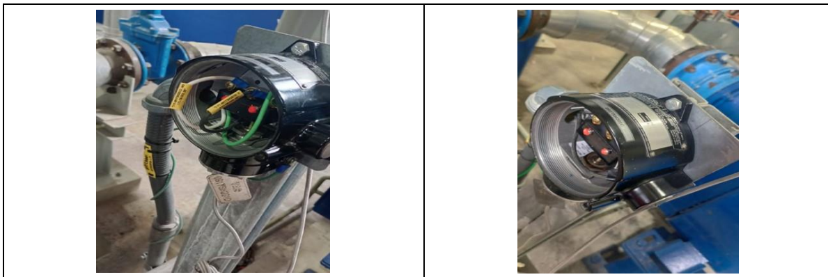
Fotografía 16. mantenimiento switch de alta temperatura
