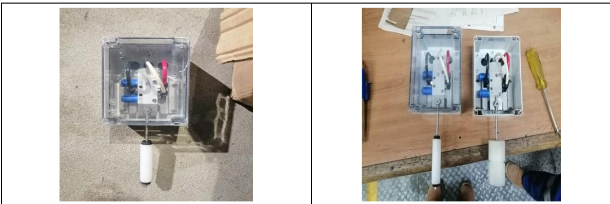
Fotografía 18. mantenimiento sensor de corrección mesa 076DEP001B
