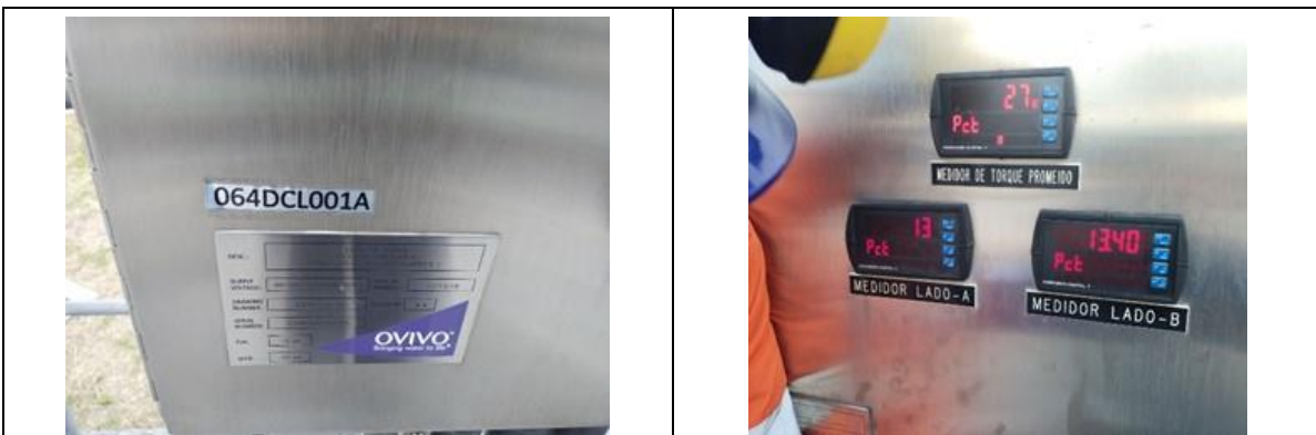
Fotografía 21. mantenimiento medidores de torque del lado A y B puente clarificador 064DCL001A
