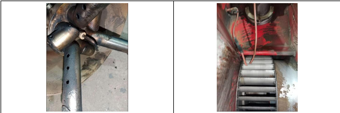
Fotografía 24. mantenimiento caldera B
