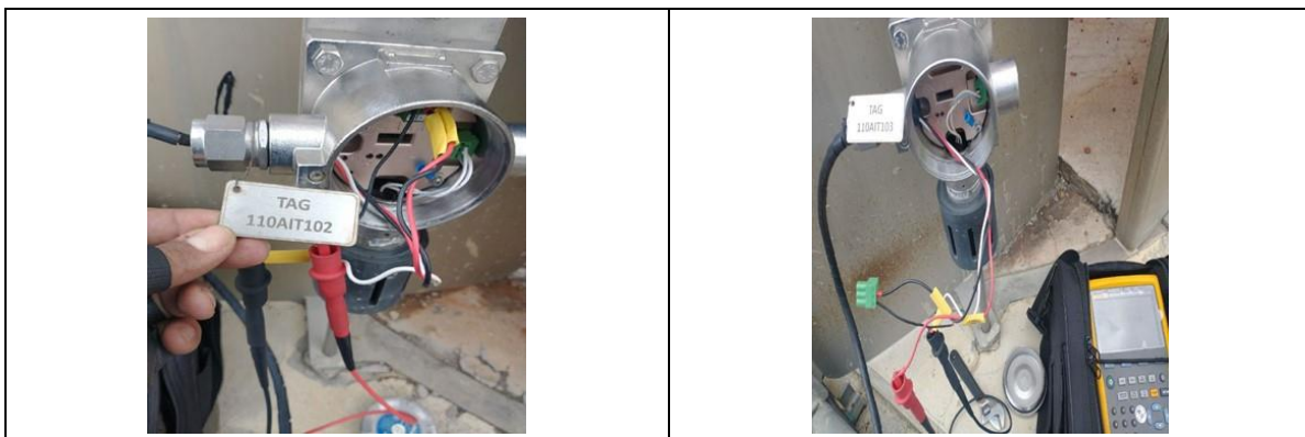
Fotografía 12. mantenimiento sensores de metano en la tea I
