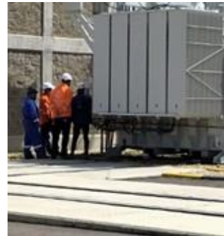
Charla sobre el manejo de la estación eléctrica al área de Mantenimiento
