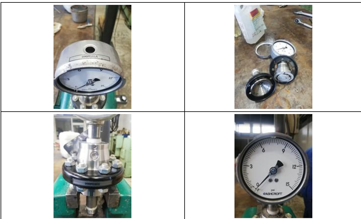
Fotografía 17. Mantenimiento preventivo a los indicadores de presión
