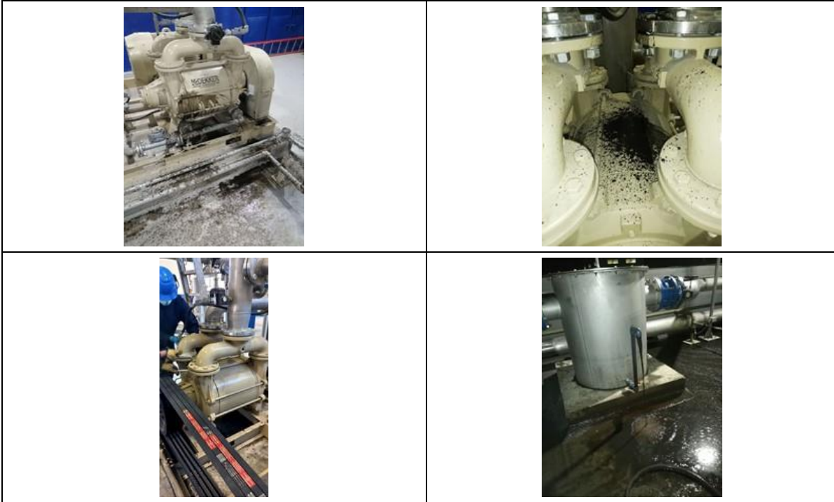
Fotografía 13. Mantenimiento Compresores de Bio Gas 072C001/072C010
