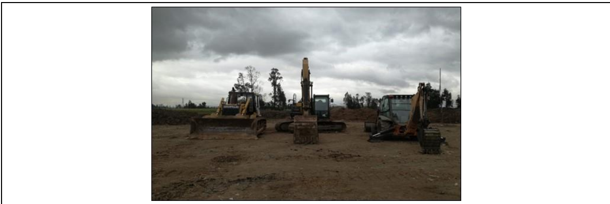
Fotografía 4. Maquinaria empleada en el patio de secado retroexcavadora de llanta tipo pajarita y el predio la Magdalena bulldozer y excavadora de oruga
