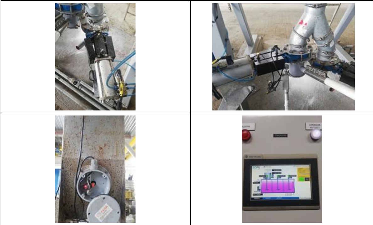
Fotografía 22. Mantenimiento skid de polímeros 074QP201B
