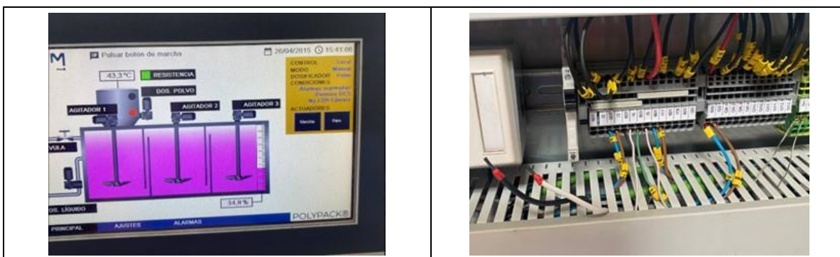
Fotografía 23. Mantenimiento skid de polimero 064QP201A
