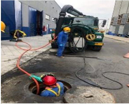
Limpieza de desagües y recirculación de polímeros.
