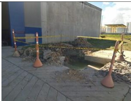
Señalización de huecos.
