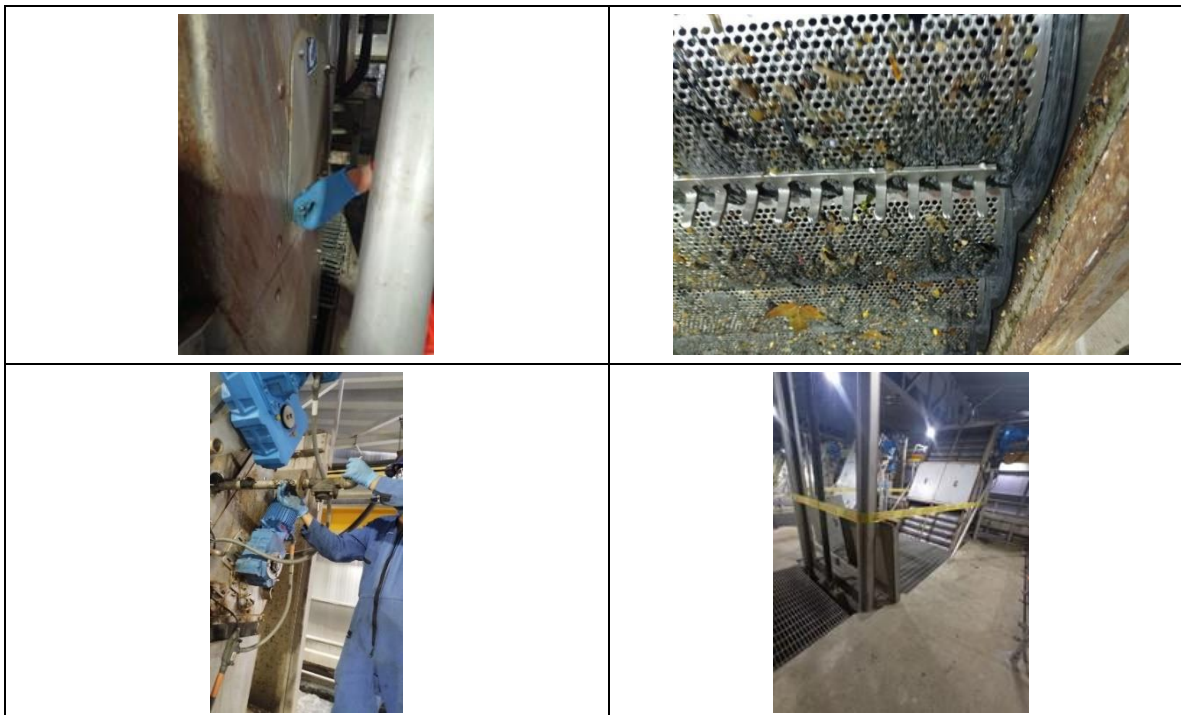
Fotografía 1. Mantenimiento reja de finos 051DGL002I
