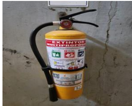
Inspección de extintores.
