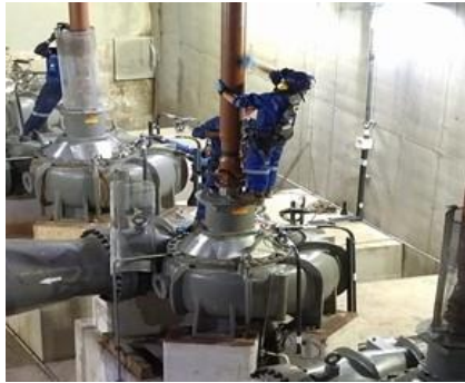
Mantenimiento preventivo de bombas de elevación.
