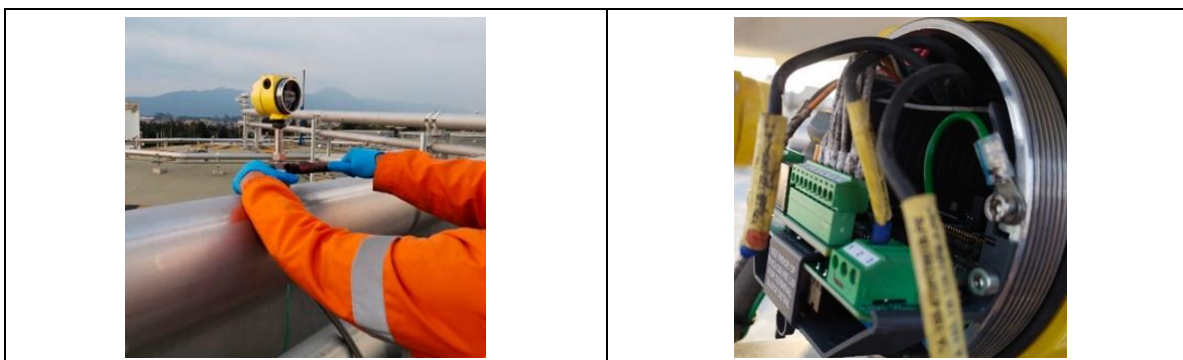
Fotografía 24. Mantenimiento transmisor y sensor de flujo del digester 2
